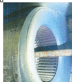
清掃前のファン内部 油汚れで黒く粉塵、カビが付着して白い
