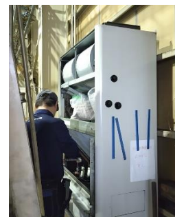
清掃前のファン内部
